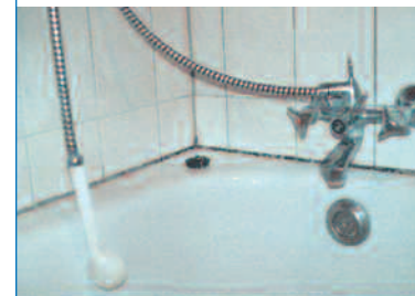
Bild 8: Beispiel für schwache Sporenexposition („Ohne besondere Gefährdung“) bei mit Schimmelpilzen befallenen Fugendichtungen
