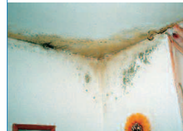
Bild 4: Schimmelpilzbefall undichtes Flachdach
