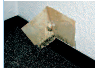
Bild 3: Schimmelpilzbefall unter der Tapete
